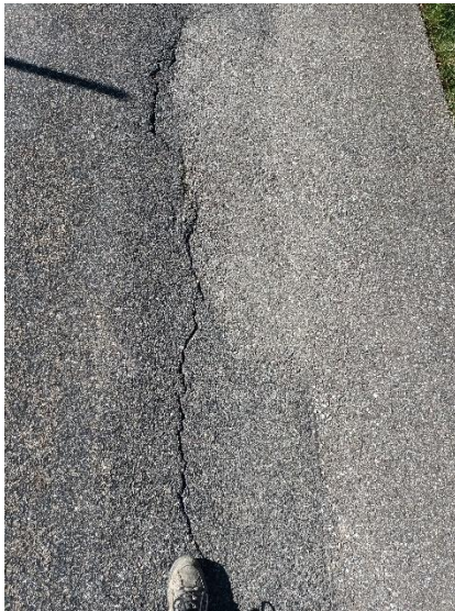
Längsriss in Oberfeldstrasse
