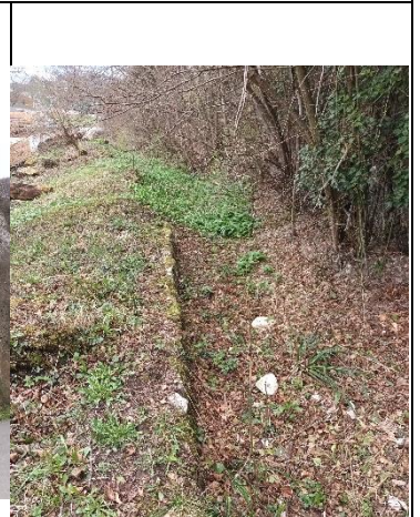
Steine im Graben/Kanal
